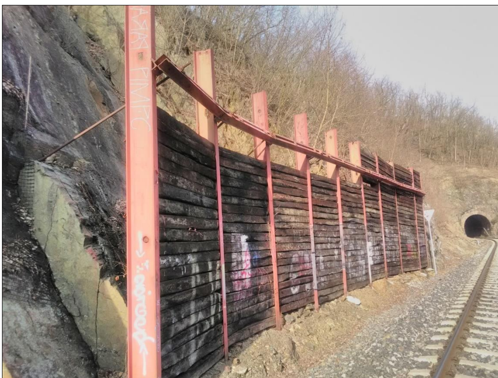
Obr. 17: Zajištění svahu nepříznivě ukloněných lavic metamorfovaných drobových břidlic záporovým pažením s kotvením.
